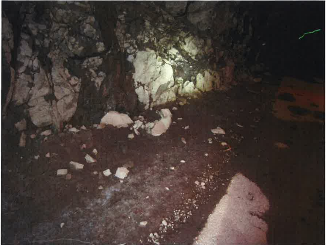
Figur 4: Mindre nedfall av berg i tverrslagstunnelen ved Nyveien
